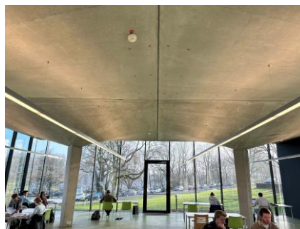
Innenraum eines Pavillons an der RWTH Aachen, Deutschland. Die Dachkonstruktion wurde mit Kohlefaserewebe verstärkt und ist nur sechs Zentimeter dick. Foto: RWTH Aachen | Thorsten Karbach
